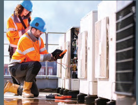
Installation und Wartung von Klimatechnik auf dem Dach.
